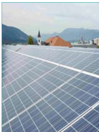
Bild: Stadtwerke Wörgl
